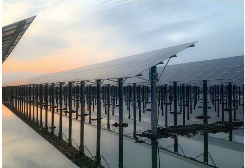
安徽六安 100 兆瓦光伏项目
